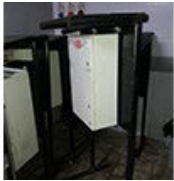
QUADRI ELETTRICI ASC
